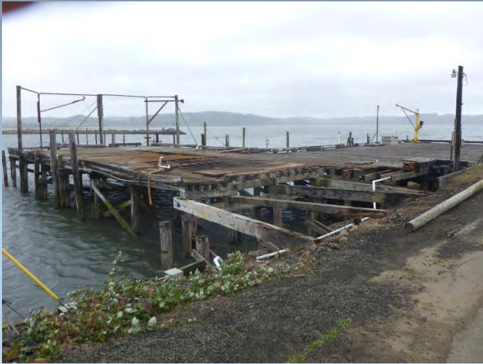
Pier falling apart #3)
